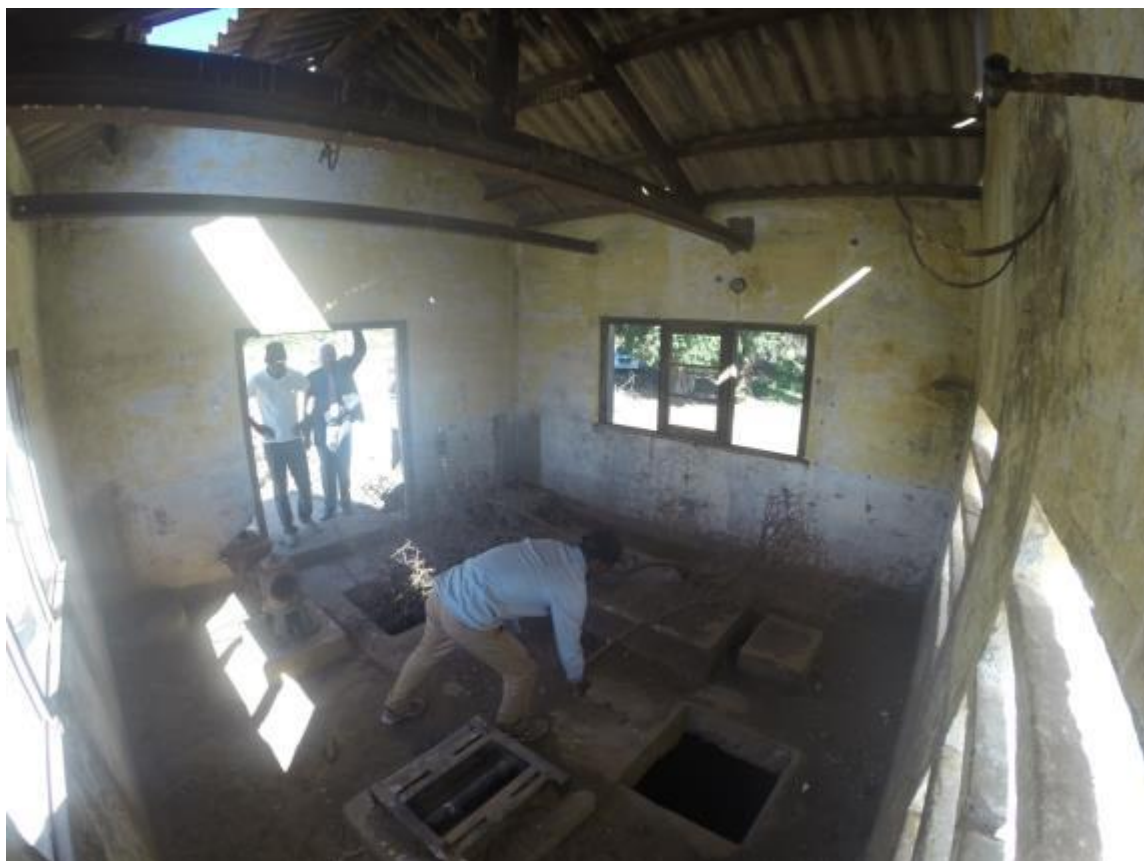
Figura 2 - Poço de captação de água do rio
